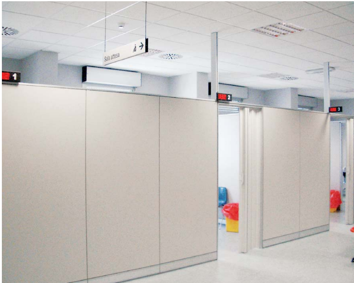
Piani secondo e terzo - sistema di raffrescamento e riscaldamento. La diffusione dell'aria da parte delle unità interne è canalizzata.
