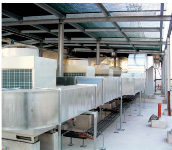
Figura 3a - Una vista generale del condotto dell'aria espulsa che alimenta le batterie delle unità esterne.
