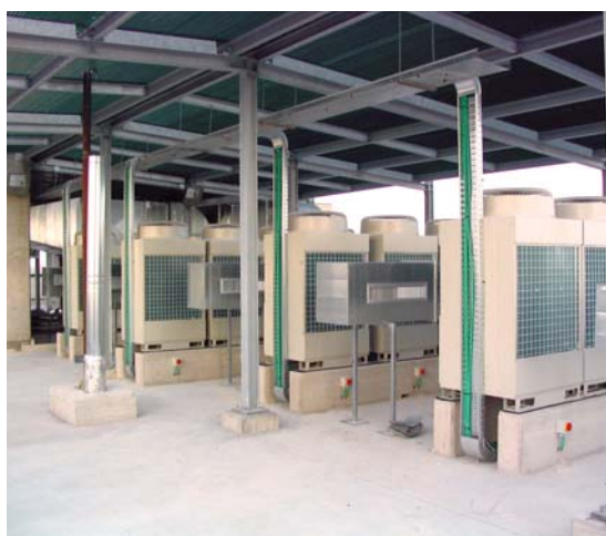
Figura 3b - Un particolare della terminazione dei canali con le bocchette di diffusione dell'aria verso le batterie stesse.
