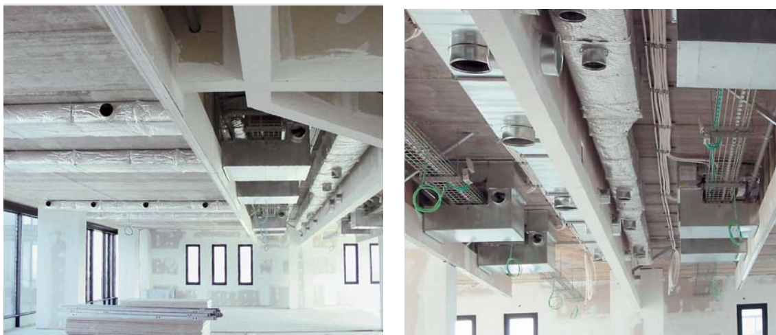
Figura 5 - Particolare dell'installazione di unità interne canalizzate. I canali alimentati dalle singole unità si sviluppano paralleli al lato corto dell'edificio e ne coprono la superficie del piano a pettine; nella foto a destra un ulteriore particolare delle unità interne installate e dei condotti dell'aria primaria e di ripresa.
