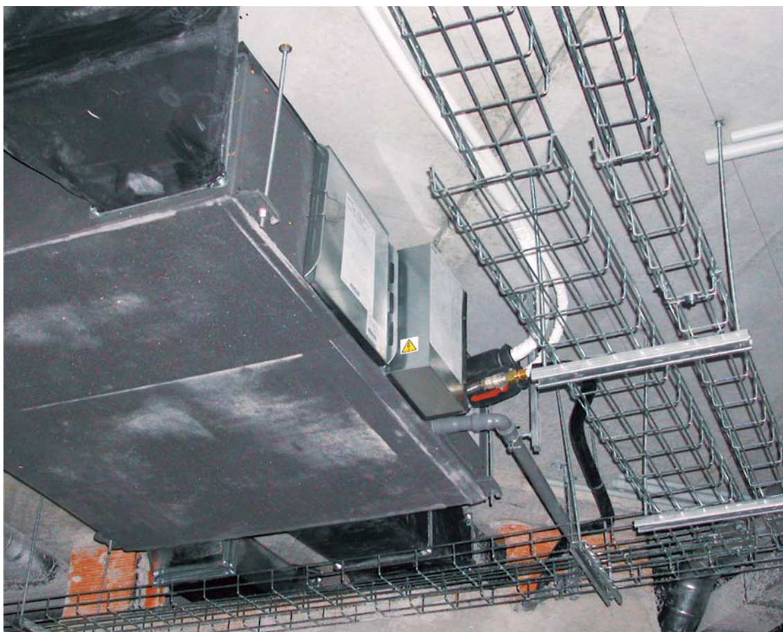
Particolare di una delle unità interne canalizzabili al di sopra del controsoffitto durante i lavori di installazione.
