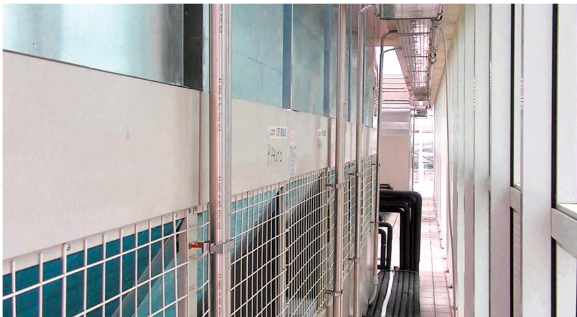
Una vista delle unità esterne degli impianti VRF installate sulla copertura, celate dall'elemento parietale. Si osservi il tratto di canale sullo scarico delle macchine per evitare il rischio di corti circuiti tra i flussi d'aria.
