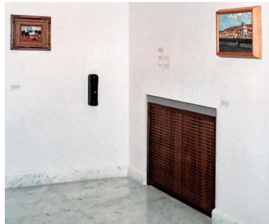
Un'altra delle sale della Galleria nella quale si osserva una unità interna di tipo verticale, installata entro una nicchia.
