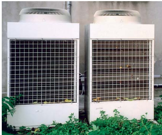
Due unità esterne degli impianti VRF a pompa di calore installate sul retro dell'edificio (Mitsubishi Electric).
