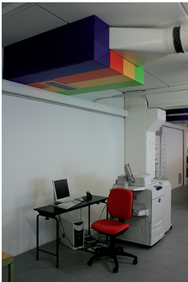
Le unità interne sono del tipo da incasso, in controsoffitto e canalizzabili, queste ultime utilizzate nel solo piano interrato.
