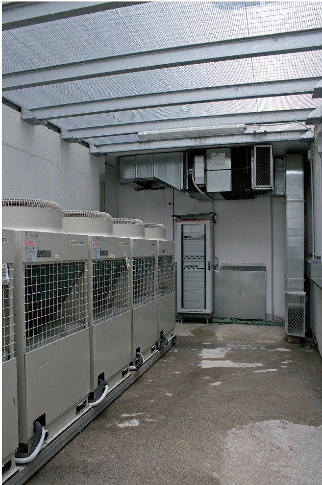
L'espulsione dell'aria esausta a valle del recuperatore di calore è direzionata nei vani tecnici, per favorire il funzionamento delle pompe di calore.
