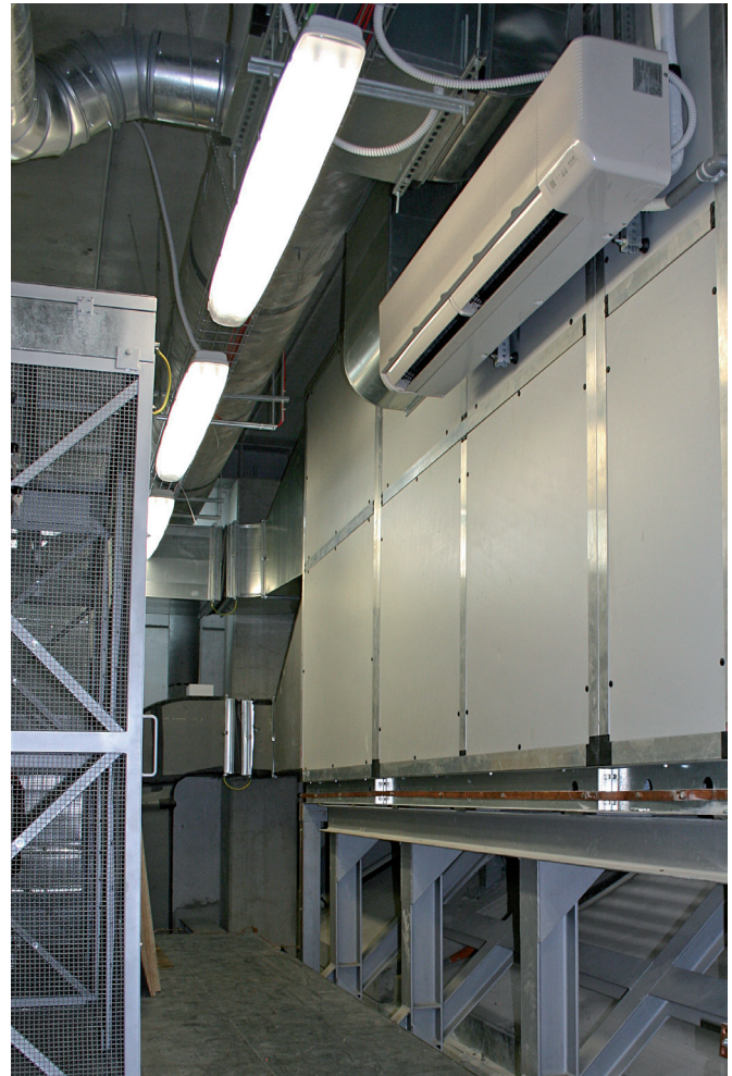
Gli spazi tecnologici, equipaggiati con split a espansione diretta, sono provvisti di un impianto di spegnimento a saturazione che serve anche il locale ced.
